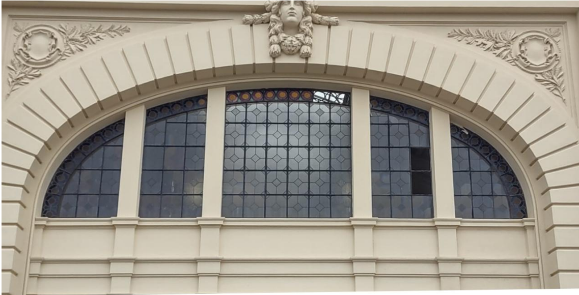
Foto acima: vitrais retirados na primeira etapa.
